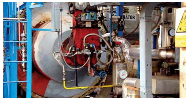
V rámci souboru prací jarního bloku provozních zářezek byla mimo jiné u spalovací komory incinerátoru provozu asfaltů celkově opravena vyzdívka.
